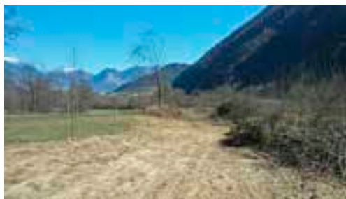
Foto 2 – Piazzale strategico le "Giare" in comune di Roncegno Terme in fase di realizzazione.
